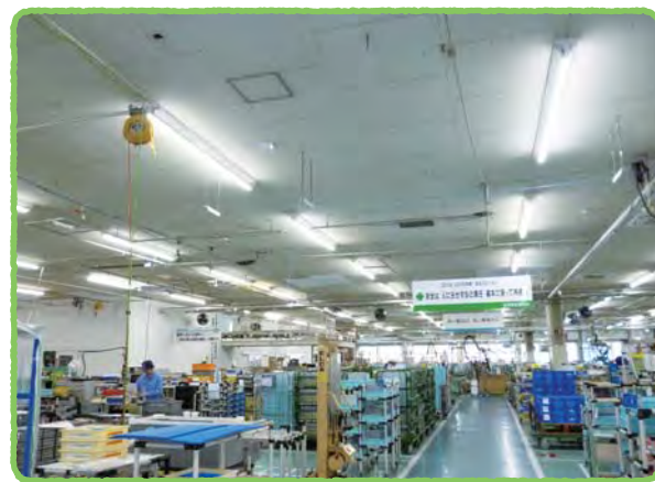
本社(業冷工場2階)のLED照明
