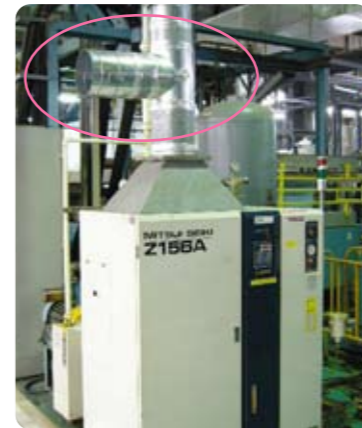
エアコンプレッサと配管
