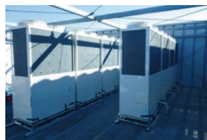
ガスヒートポンプエアコン室外機
